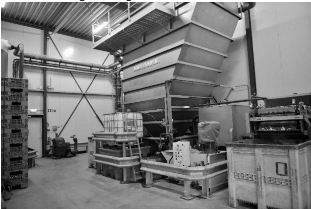
Afbeelding: de waterzuiveringsinstallatie bij Greydanus
